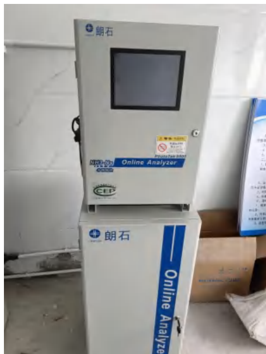
废水在线监控设施（氨氮）
