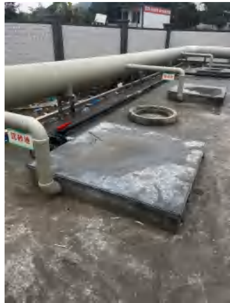
沉砂池、隔油池
