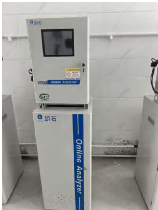
废水在线监控设施（总氮）
