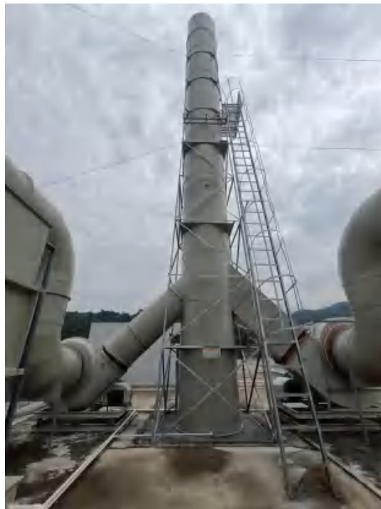
废气处理设施及排气筒
