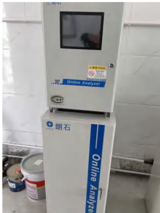
废水在线监控设施（总磷）
