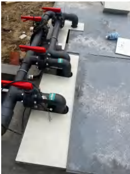
调节池及提升泵
