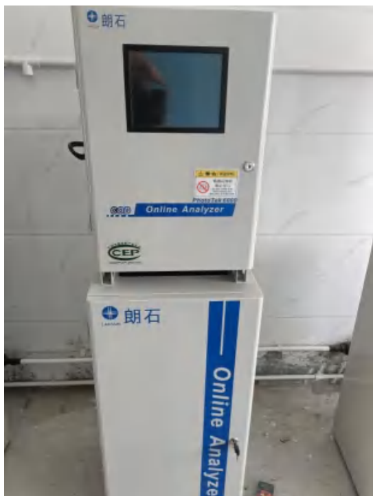
废水在线监控设施（cod）
